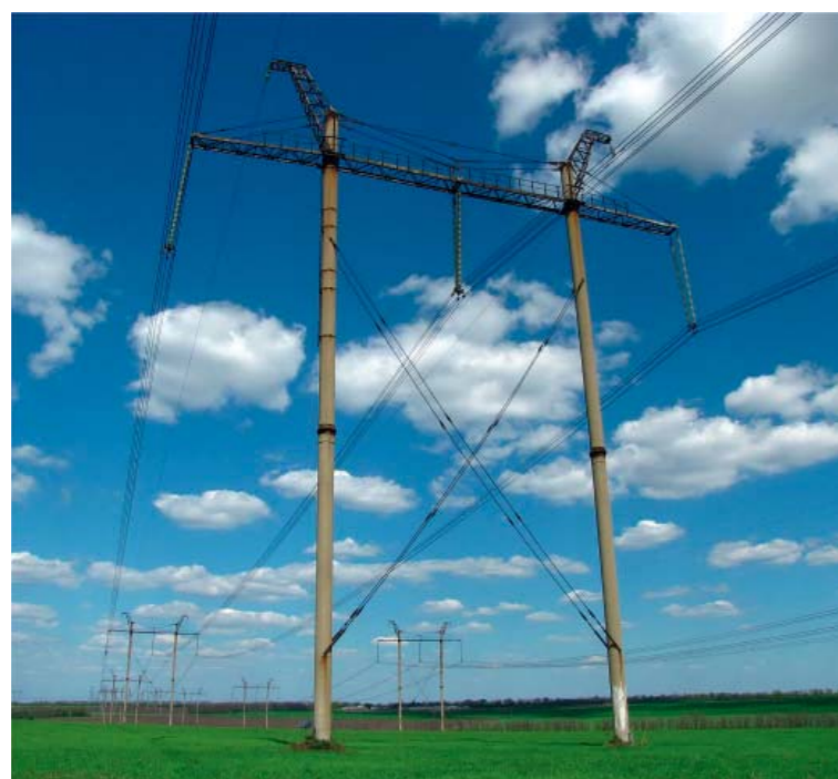
Рис. 1. Опора ПБ750 на ВЛ 750 кВ Запорожская АЭС — ПС «Запорожская»
